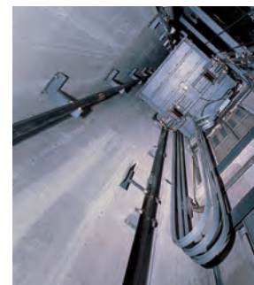
エレベータ用ケーブル
